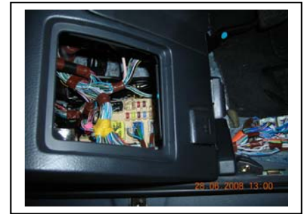
Anschluss Kabel Stromversorgung Modul
